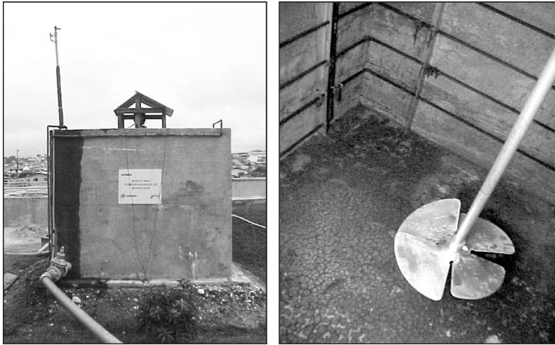
Figura 2.13 Termo-hidrolisador, tubulações internas de cobre e misturador do lodo.
