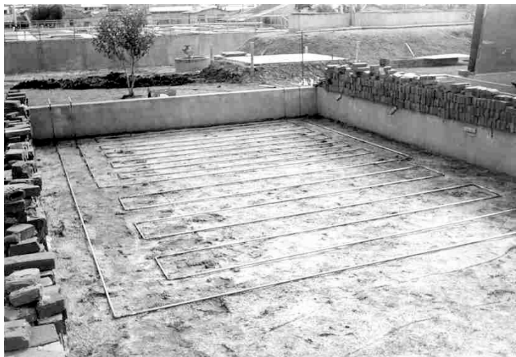
Figura 5.5 Leito de secagem com tubulação de cobre.
